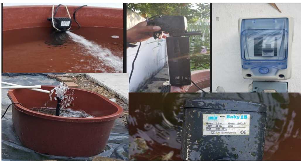
Figura 8. Detalle del sistema eléctrico y oxigenación del sistema.
